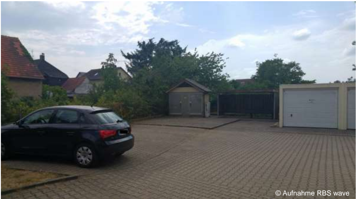
Abbildung 3-1: Parkplätze hinter Rathaus mit Ortsnetzstation in Bietigheim
